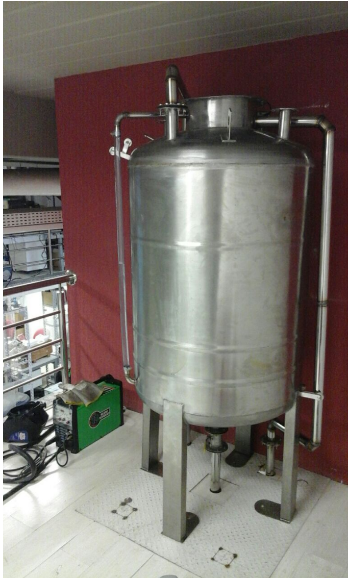
Figura 3.17: Tanque Superior com capacidade de 500 litros.
