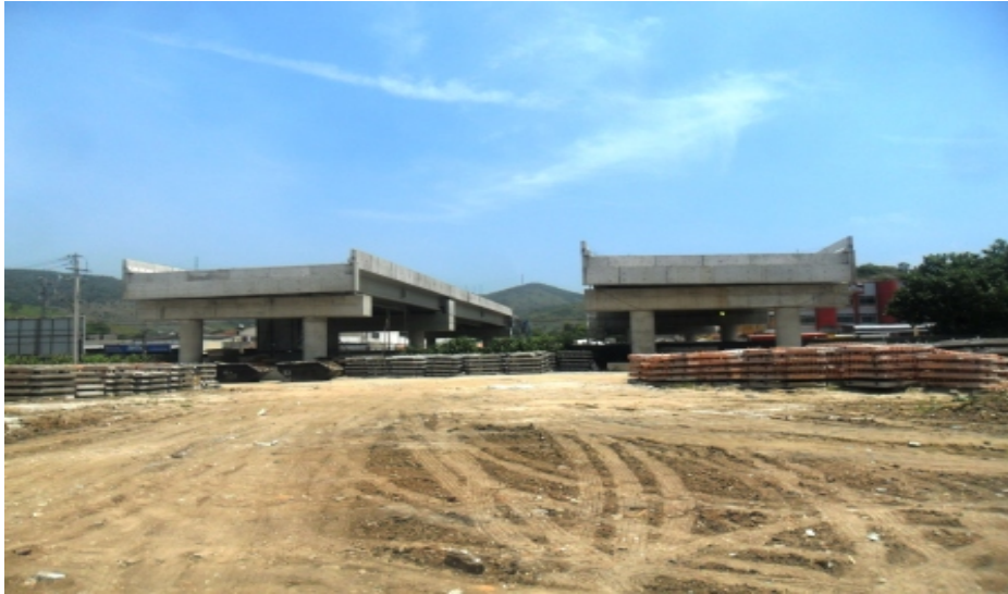
Figura 8 - Futuro encontro entre viaduto e aterro com fitas metálicas em Sulacap, RJ. (Autor)
