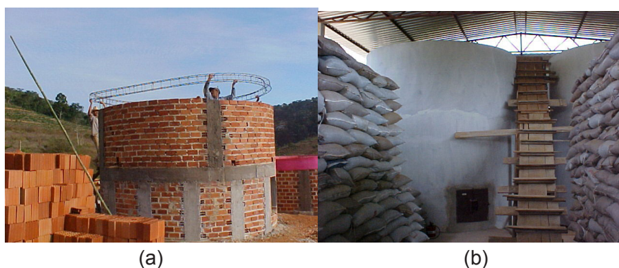
Figura 2 – Vista parcial da construção de um silo (a) e do silo pronto (b).
