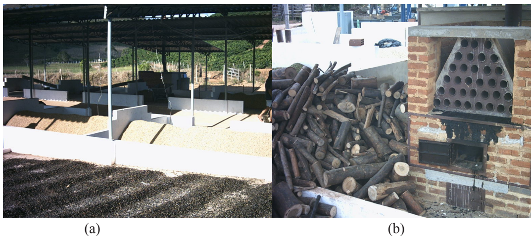
Figura 1 – Vista parcial do secador de camada fixa (a) em leiras (“híbrido”) e da fornalha (b).
