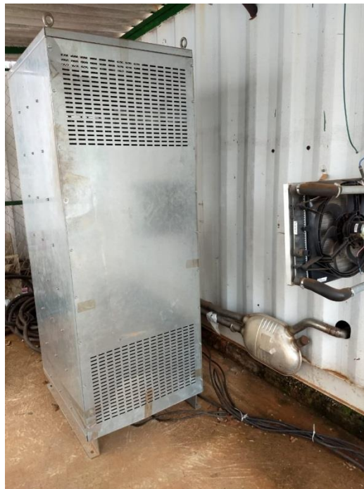
Figura 18 - Banco de resistores e o escape do motor. Fonte: autores.
