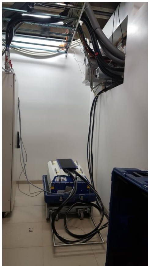
Figura 43 - Unidade de fonte de energia 3600 MPSU, com seus cabos de energia, comunicações CAN e RS-232 conectados, pronta para iniciar o processo de Ramping . Imagem de acervo pessoal.
