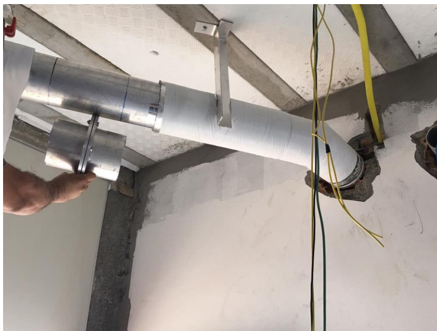
Figura 35 – Tubo Quench em etapa de readequação, depois de detectadas não-conformidades em sua instalação. Na situação em questão, foi necessário a instalação de uma “barriga ( Flexible bellow )” para reduzir efeitos destrutivos de dilatação térmica. Imagem de acervo pessoal.
