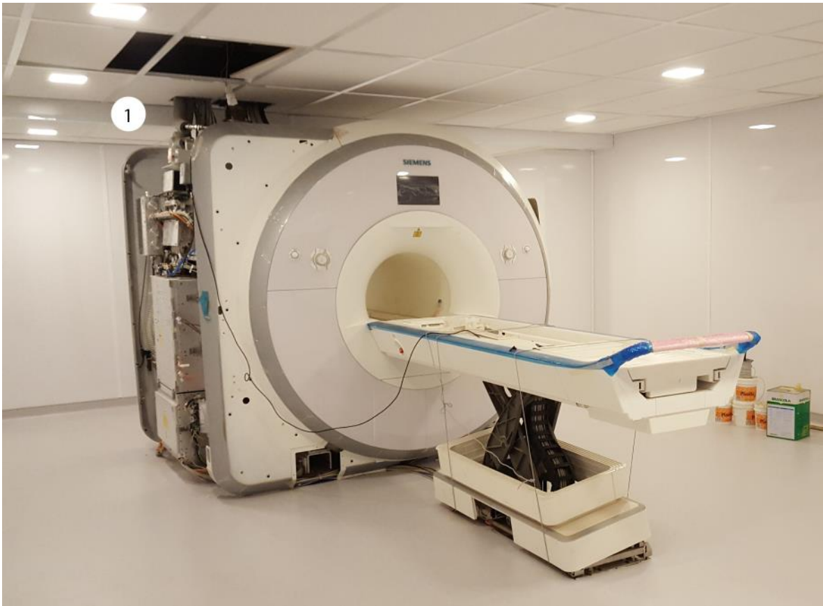
Figura 39 - Sala de exames de um sistema de ressonância magnética. O local em questão se trata do mesmo representado pela figura 35, mas agora com sua gaiola e acabamento estético finalizado, restando apenas acabamentos de carenagem à esquerda do equipamento e na mesa do paciente. Em “1”, é possível observa-se a passagem do tubo quench da sala de exames para o exterior da sala. Imagem de acervo pessoal.
