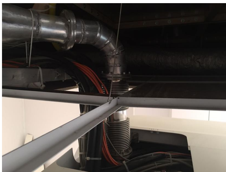
Figura 36 - Tubo Quench sem isolamento térmico adequado, onde também se viu necessária realização de readequação antes de se prosseguir com o Startup do equipamento de ressonância. Imagem de acervo pessoal.
