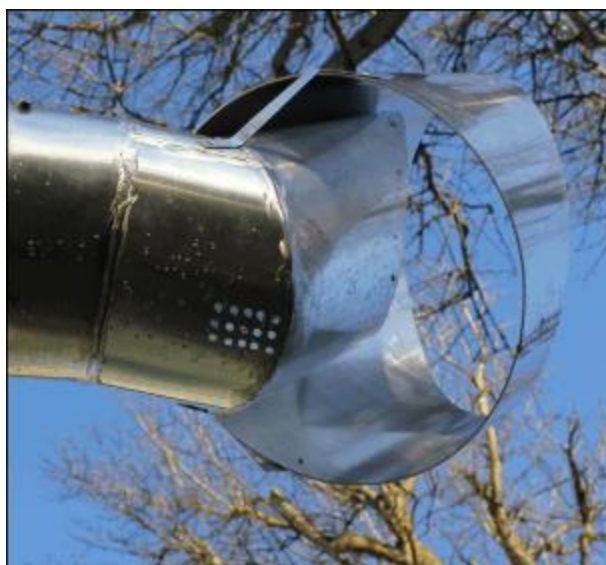
Figura 32 – Respiradouro á saída do tubo quench, com uma proteção angular contra água proveniente de chuva logo acima [56].
