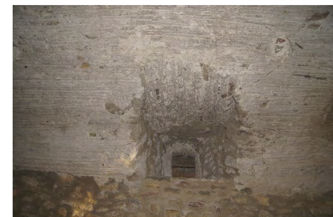
3. Començament de la volta catalana i mur de càrrega de 100 cm amb una petita obertura cap a l'exterior
