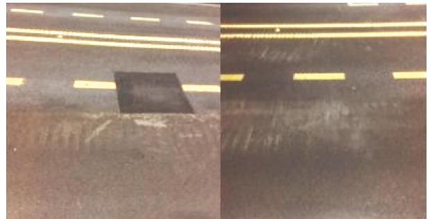
图2 厦门BRT思北路口车站段病害
