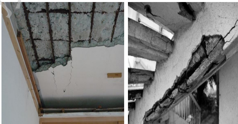
图 1.2 不合格海砂对结构造成的严重破坏
