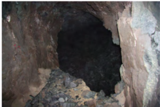
(a) +920 m 回风巷道垮塌
