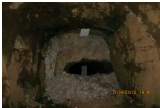
(b) +1090 m 巷道开裂错动
