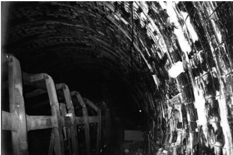
Figura 1-4. Incendio en el túnel-canal Francia-Reino Unido 18/11/1996.
