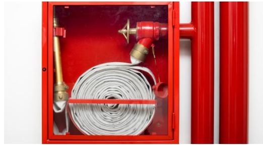
Figura 12. Caja de manguera contraincendios.
