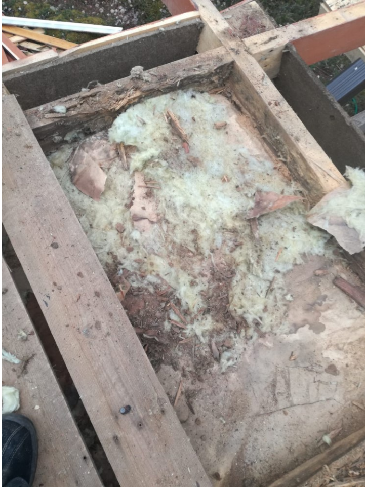
KUVA 2. Kivivilla on kärsinyt pahoja vaurioita kosteuden ja puutteellisen tuuletuksen takia.
