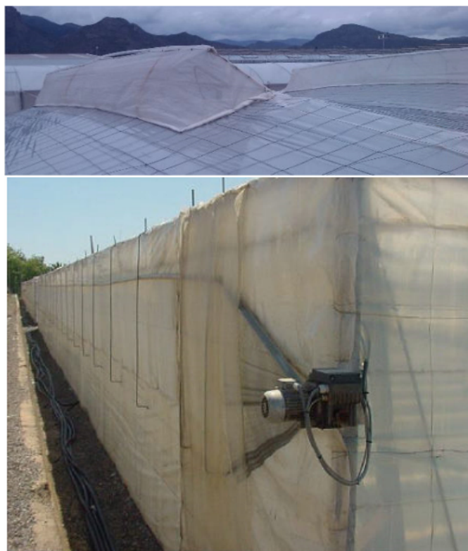
Fig. 2.3. De arriba abajo: Ventana cenital y ventana lateral de la Nave 7 de la Estación Experimental de la Fundación Cajamar “Las Palmerillas” [11].
