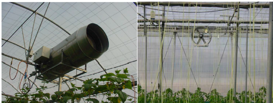
Fig. 2.6. Sistema de calefacción aeroterma de la Nave 7 de la Estación Experimental de la Fundación Cajamar “Las Palmerillas. Quemador diésel a la izquierda y ventilador de distribución a la derecha [11].
