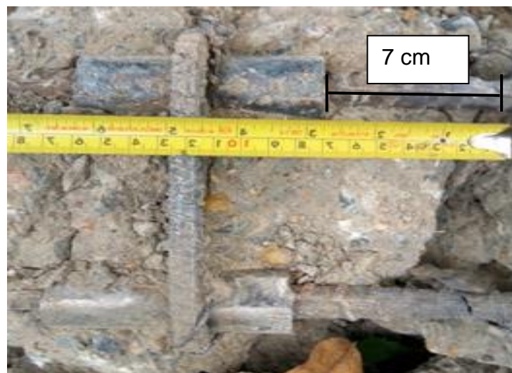
Figura 70. Falla en probeta tipo D6S14E1.
