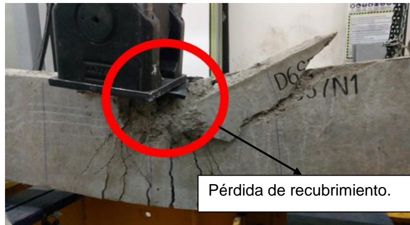
Figura 69. Pérdida de recubrimiento.
