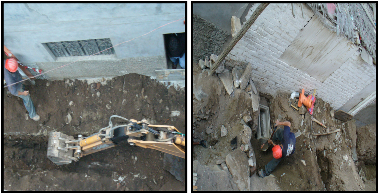
Proceso de dotación del servicio de agua y desagüe en el AA. HH.
