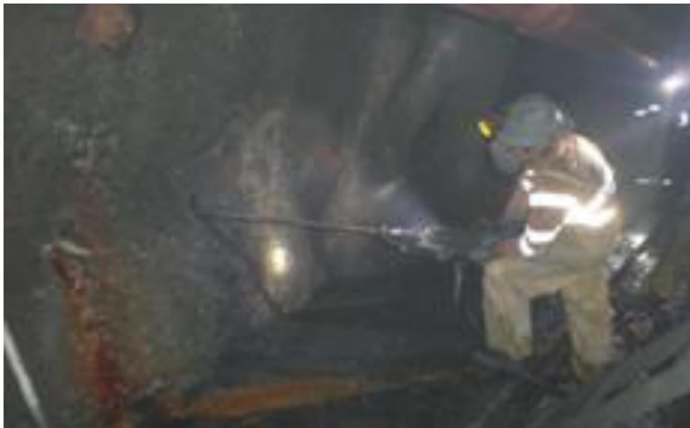
Figura 3.33. Vista de perforación e instalación de tubería de drenaje en galerías, Fuente: Electroperú, (2014).
