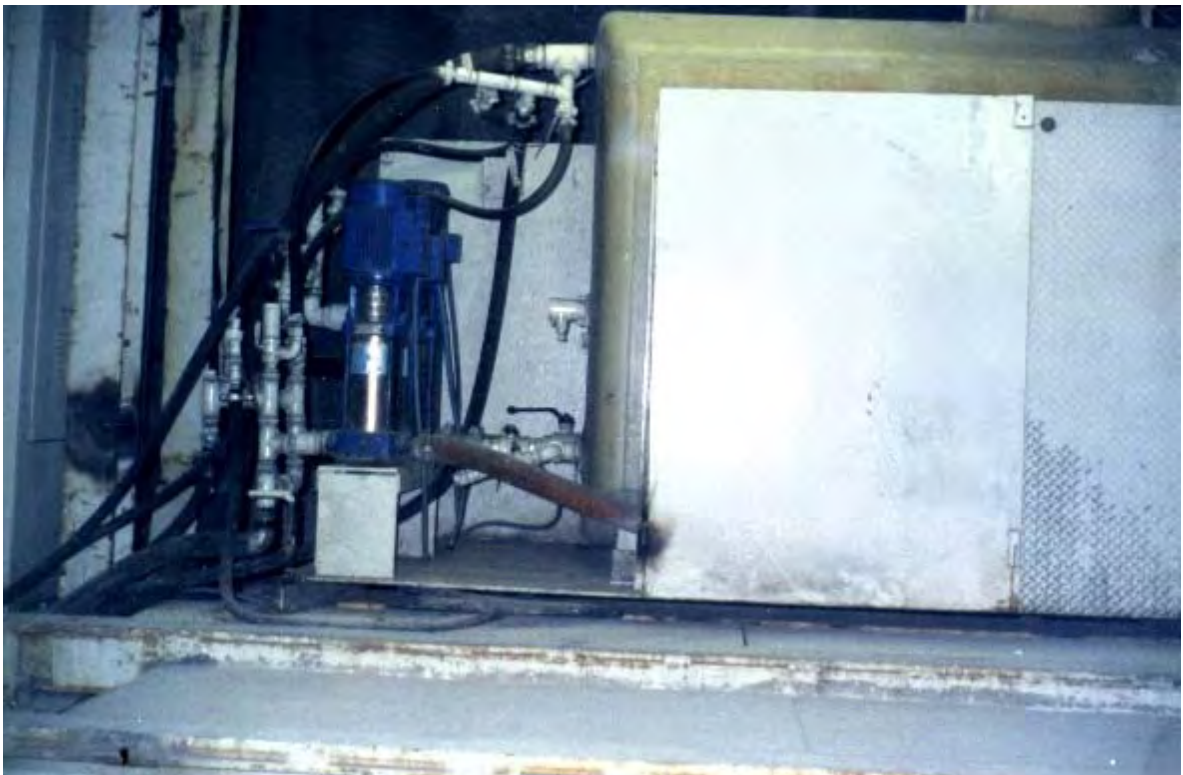
Fotografía N° 3-28: Sistema de abastecimiento de agua, se observa el tanque y la bomba
