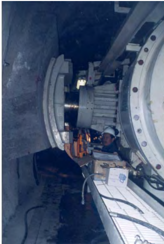
Fotografía N° 2-22: Gripper posterior izquierdo de la “TBM MK 12” fijado en la losa de arranque
