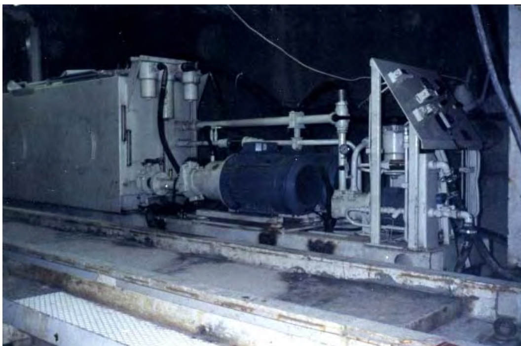
Fotografía 3-25: Planta hidráulica (power pack) mostrando entre otros, las 3 bombas hidráulicas (empuje, fijación y circulación), tanque de aceite, tablero de mando, todos sobre el back up.
