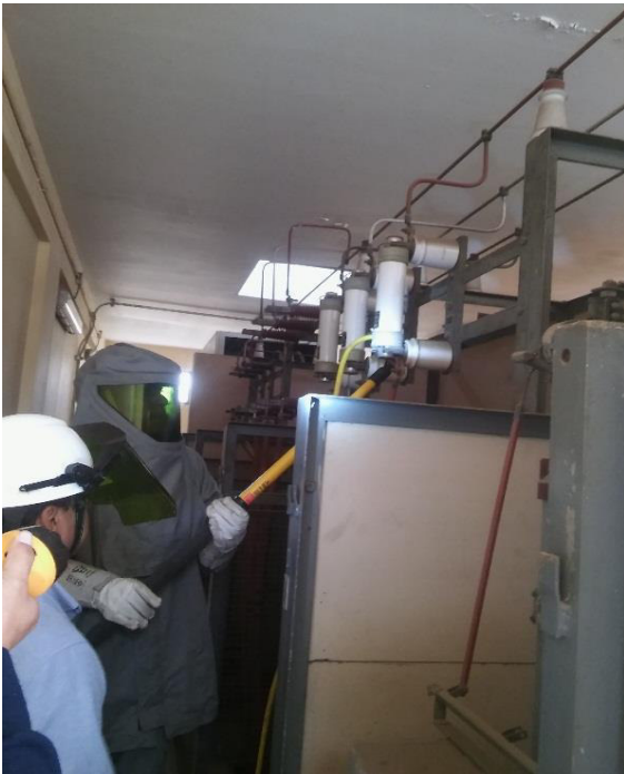
Maniobra de eliminación de energía Residual
