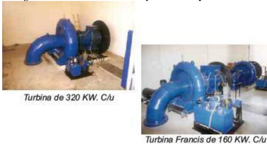
Fig. 2.9: Turbinas Francis de 320 y 160 KW respectivamente.
