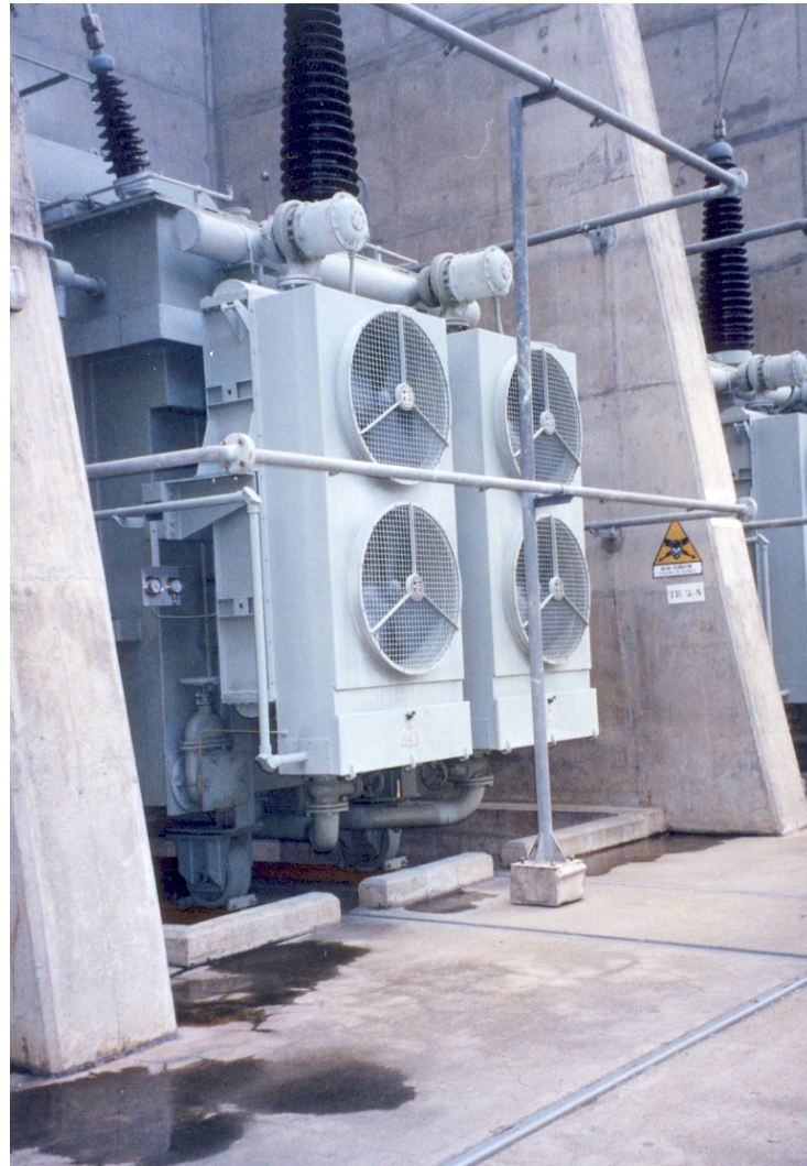
Fotografía 3.1: Transformador de Potencia de la Central Hidroeléctrica Santiago Antunez de Mayolo
