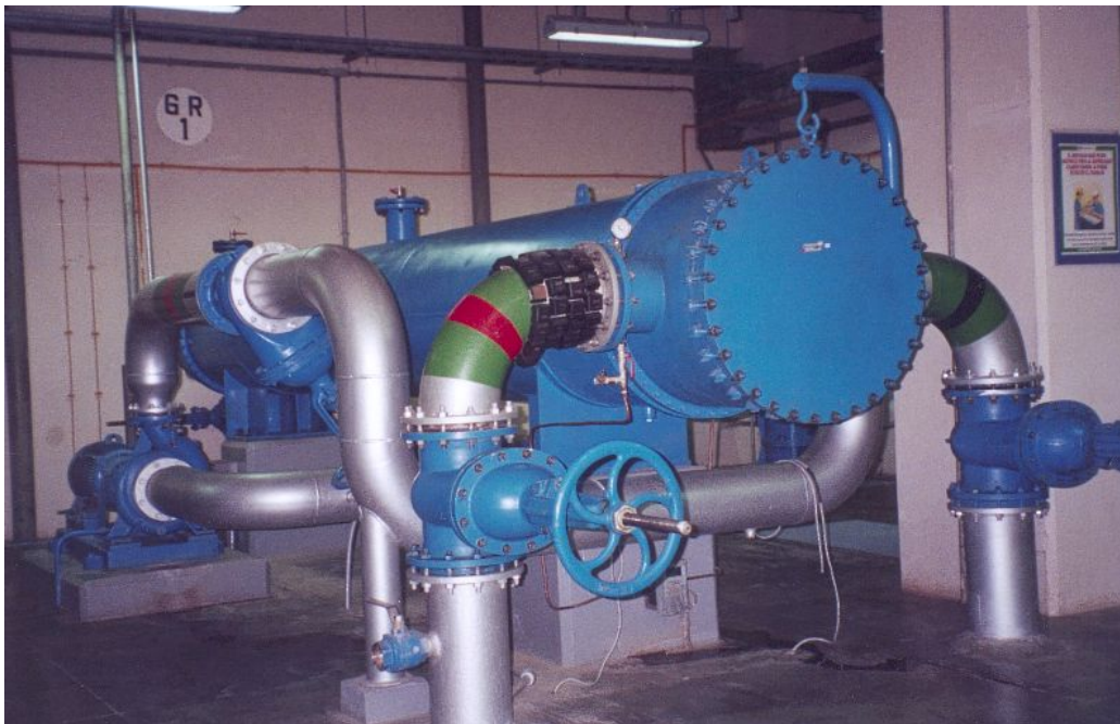
Fotografía N° 4.1 Intercambiador de calor de coraza y tubos del Grupo N° 1 – Central Hidroeléctrica Santiago Antúnez de Mayolo
