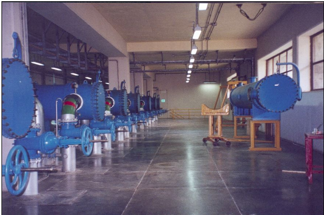
Fotografía N° 1.3 Sala de Intercambiadores de Calor de Coraza y Tubos de la CH SAM
