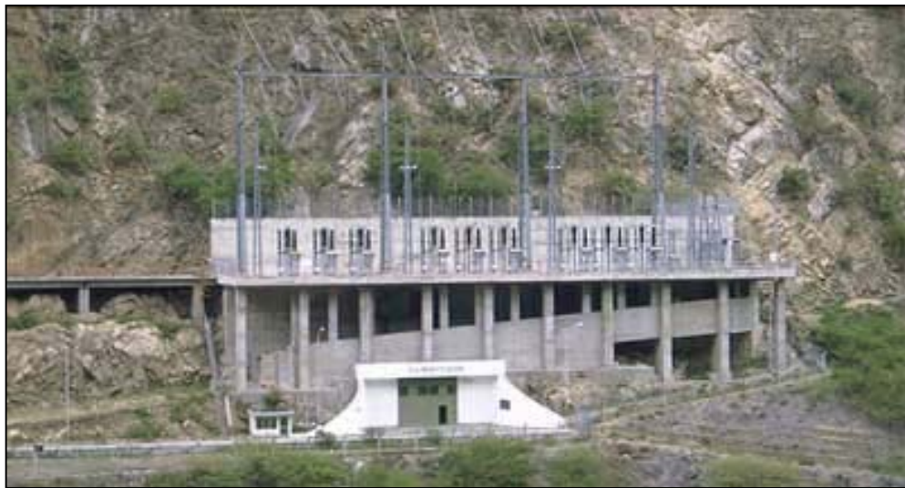
Fotografía N° 1.2 Central Hidroeléctrica Restitución (RON)
