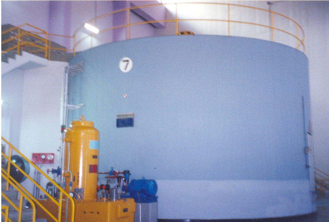
Fotografía 3.2: Generador de Potencia de la Central Hidroeléctrica Santiago Antunez de Mayolo
