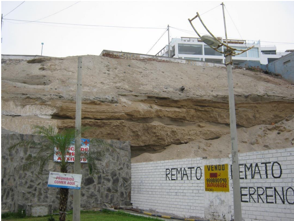
Erosión de laderas por desestabilidad del talud natural
