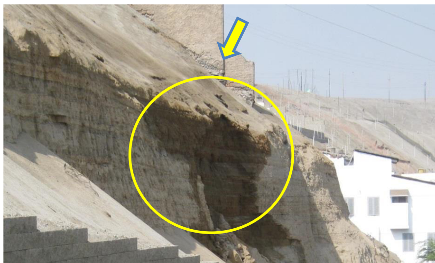
Fotografía 7.9 Humedad del suelo y muros perimétricos en mal estado en la Urb. Miramar (registro propio, febrero -2013).
