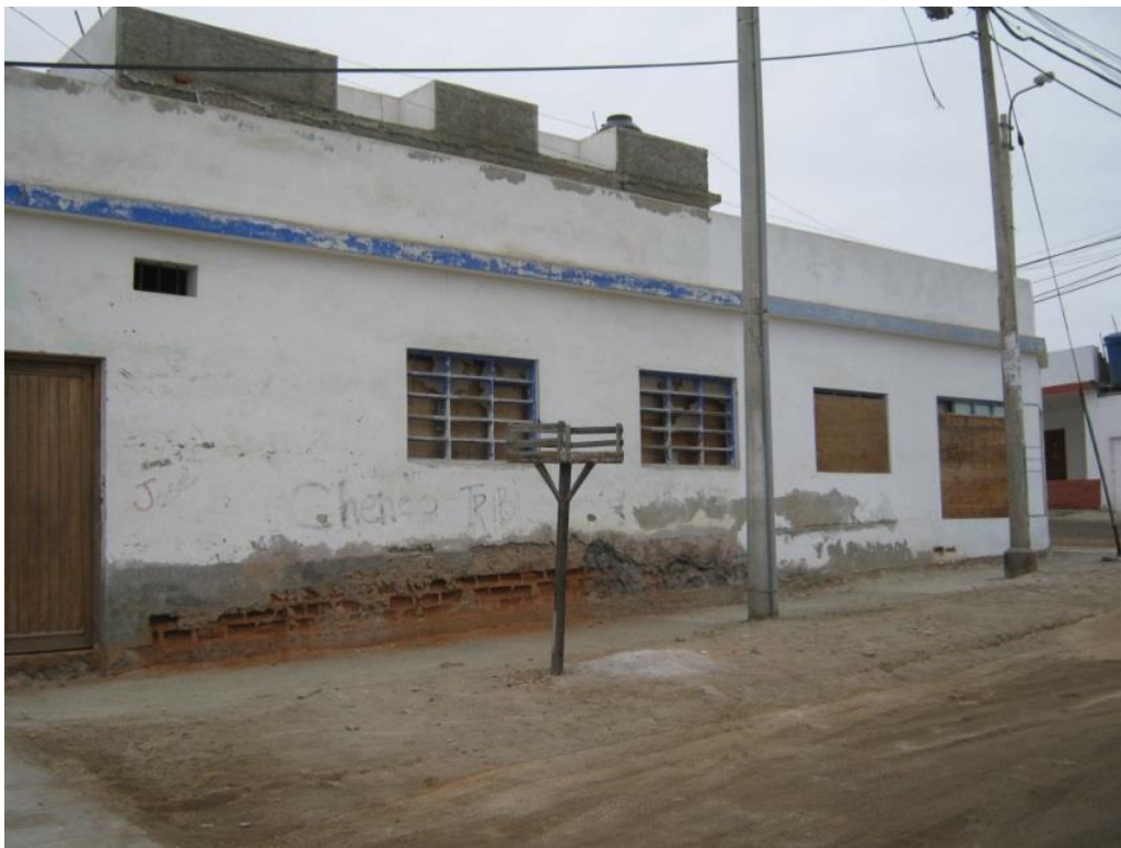
Viviendas afectadas por la humedad y el salitre.
