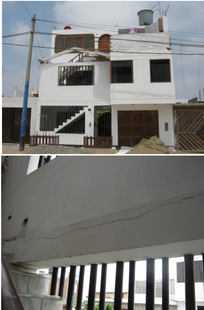
Fotografías 5.6 La imagen superior muestra una vivienda en la Urb. Santa Cruz sin mayor daño aparente, pero al ingresar se observa daño estructural en vigas (imagen inferior) (registro propio, noviembre -2012).
