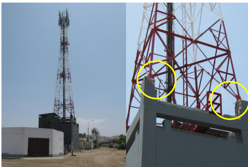
Fotografías 7.16 Antena de telefonía en la Urb. Miramar. Los círculos amarillos resaltan las bases deterioradas de la antena (registro propio, octubre -2012).
