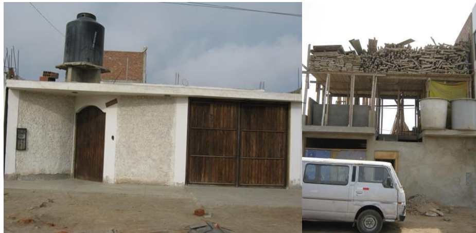
Fotografías 5.11 Sobrecarga inestable en las viviendas (registro propio, noviembre -2012).
