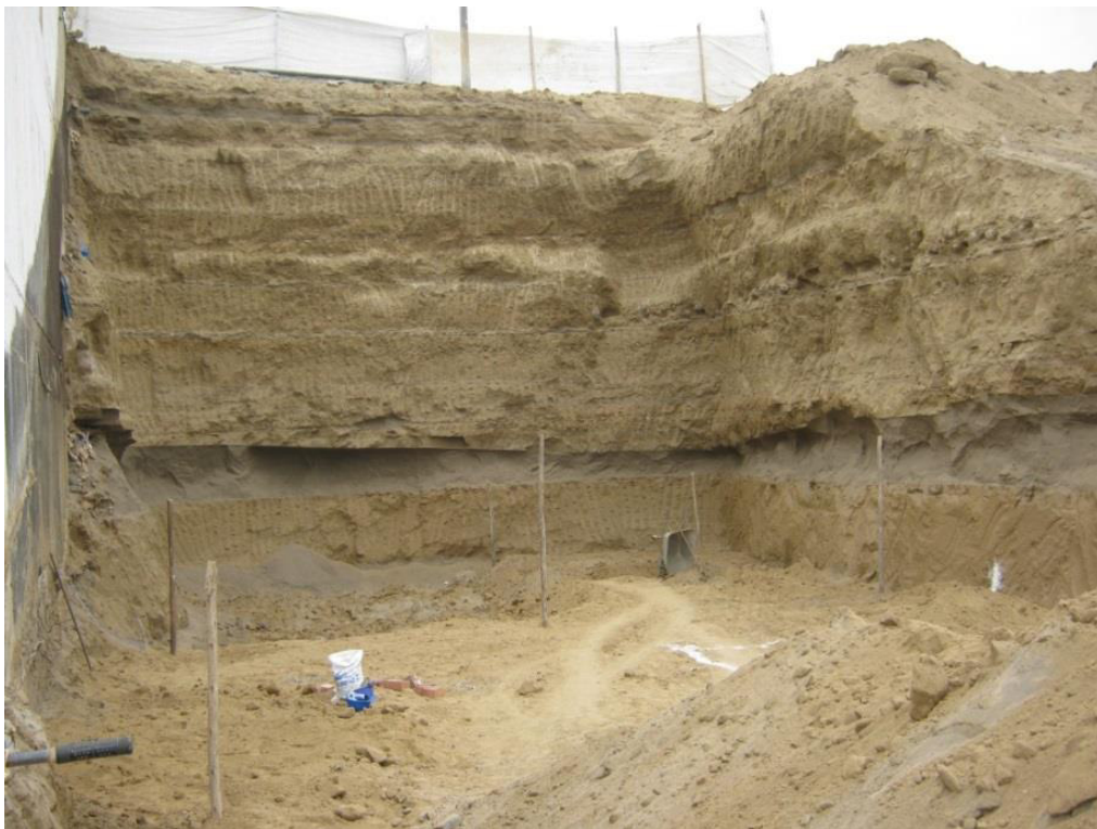
Corte del talud natural en las playas Caballero y Señoritas con fines constructivos.
