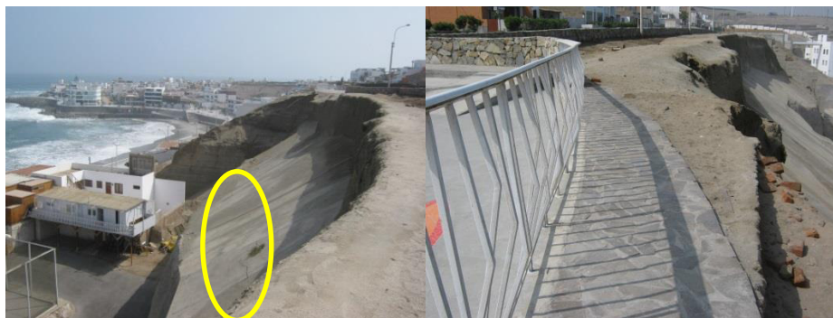
Fotografías 7.8 Fractura de obras realizadas para estabilizar el talud. Imagen derecha fractura en la base del mirador (registro propio, febrero -2013).
