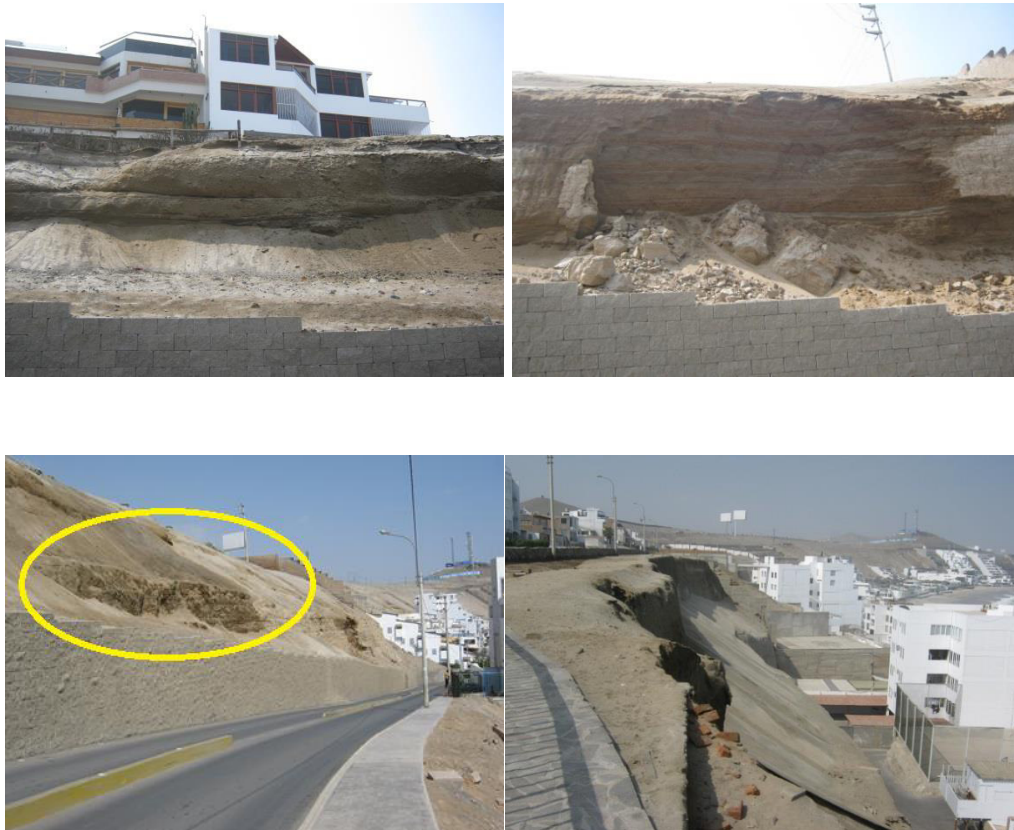
Fotografías 7.7 Erosión de laderas, percolación de aguas subterráneas y desprendimiento de bloques de suelo (registro propio, febrero -2013).
