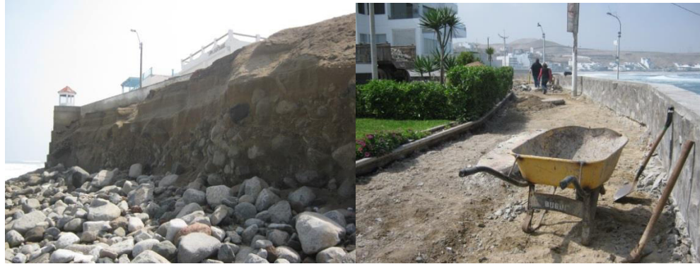
Fotografías 7.6 La erosión marina afecta las obras públicas (registro propio, febrero -2013).
