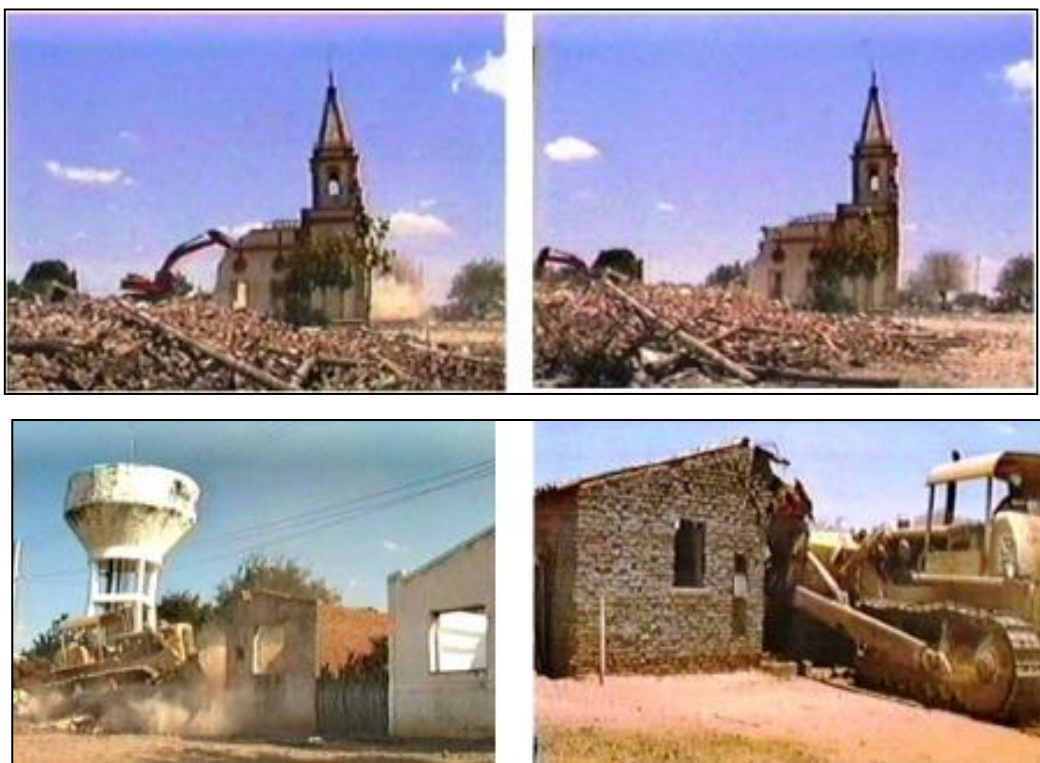
*Fotos 9, 10 acima: Destruição da igreja matriz. – Foto 11, 12 - Destruição da caixad'água da cidade e de uma das casas.
