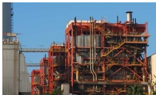
Fig. 18 - Vista lateral das caldeiras de tipologia exterior ou "outdoor" da Central Termoelétrica de Setúbal. Setembro 2014
