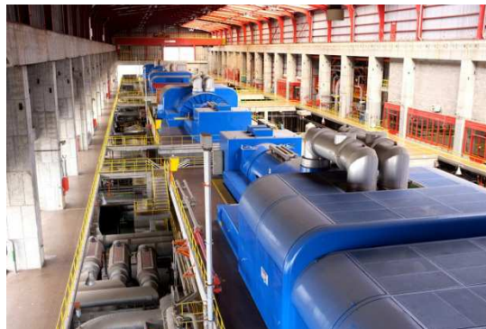
Fig. 32 - Interior da sala de máquinas (cota +11,00) com os quatro turbogrupos (cortesia Júlio Matos, 2011)
