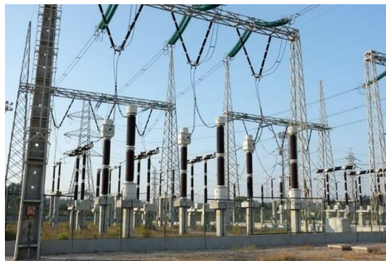
Fig. 37 - Parque de Alta Tensão
