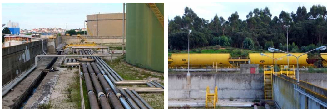
Fig. 20 - Parque de combustível (bacias de retenção, oleoduto e reservatórios) e Terminal Ferroviário no interior da Central Termoelétrica de Setúbal a Novembro de 2014.
