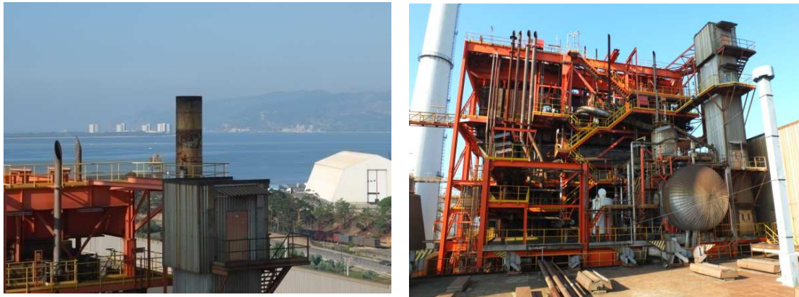
Fig. 31 - (a) Geradores de Vapor com vista para a Serra da Arrábida e Península de Tróia (b) Vista lateral de um dos quatro geradores de vapor tipo exterior
