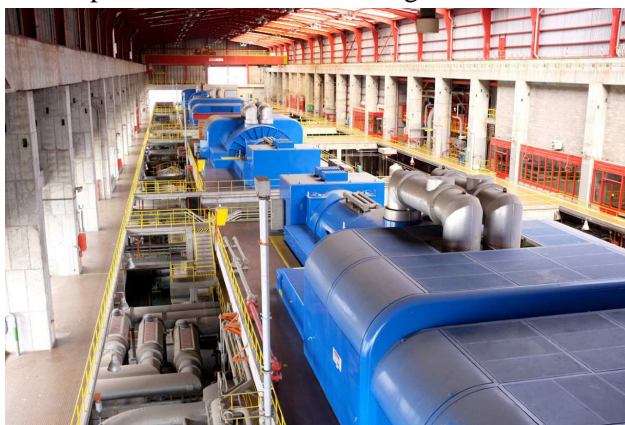
Fig. 16 - Disposição Longitudinal dos quatro turbo-grupos na Sala de Máquinas da Central Termoelétrica de Setúbal (cortesia de Júlio Matos)
