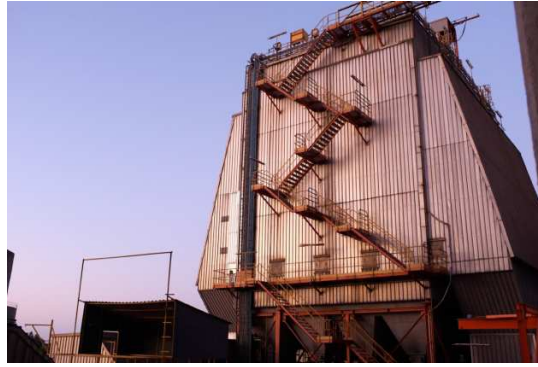
Fig. 34 - Um dos dois Despoeiradores Eletroestáticos (cortesia Júlio Matos, 2011)
