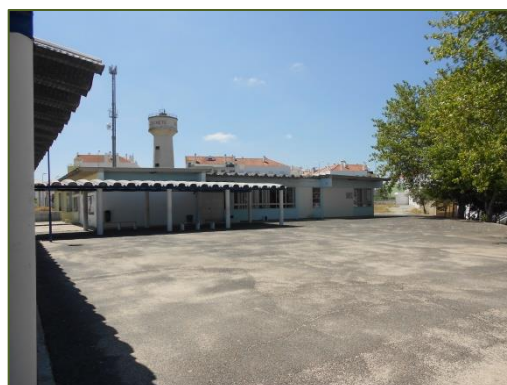
Figura 29 – Presença de Amianto no Bloco de Salas de Aula
