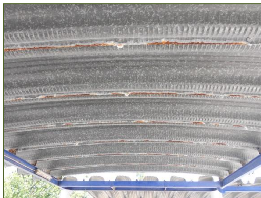
Figura 26 – Presença de Amianto no corredor de acesso entre vários blocos de Salas de aula
