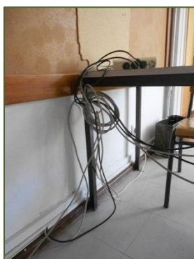
Figura 30 – Cabos elétricos sem proteção
