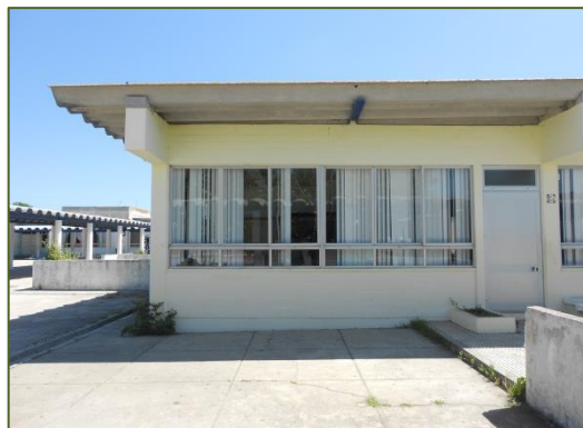
Figura 27 – Presença de Amianto no Bloco de Salas de Aula
