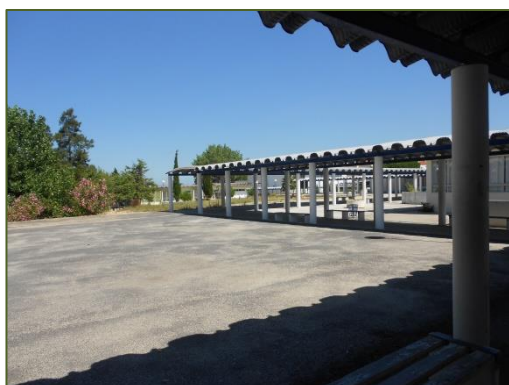
Figura 28 – Presença de Amianto no corredor de acesso entre vários blocos de Salas de aula
