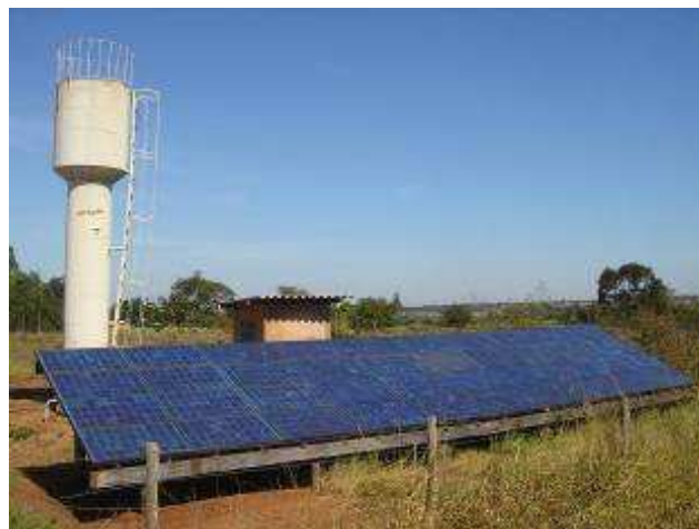
Figura 5: Sistema fotovoltaico de bombeamento do PRODEEM revitalizado com a configuração SFB-CF, Pontal do Paranapanema-SP, Brasil.
