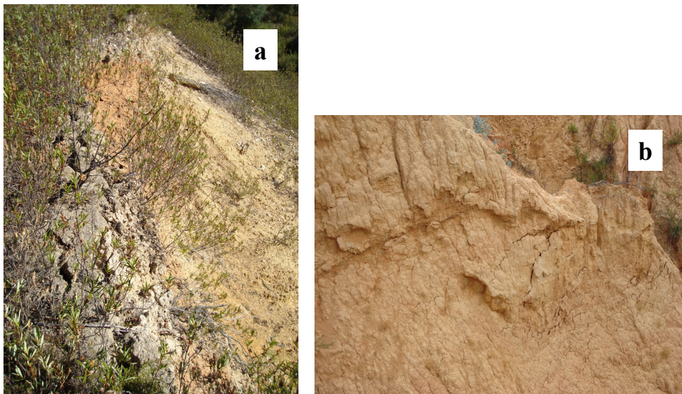
Figura 107 - Fracturas de tensão ao longo do perímetro da forma F29 (a); Padrão de fracturação por dessecação na forma F26 (b).
