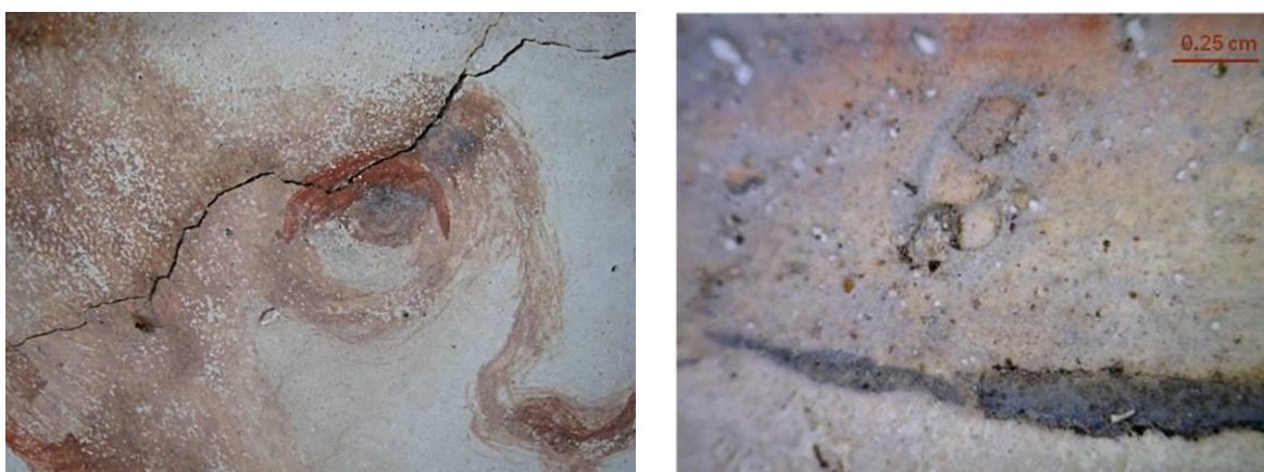
Figs. 19 e 20 – Fissuras e poeiras nos “panos das abóbadas” da Sala da Tomada de la Goleta . Fotografias no espectro visível, sem ampliação e macro, com o Dino-lite, respectivamente. © Filipa R. Cordeiro.
