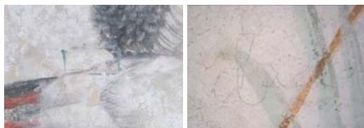
Figs. 10 e 11 - Patologias observadas no salão das Armas , causadas pelo factor humano de degradação.
