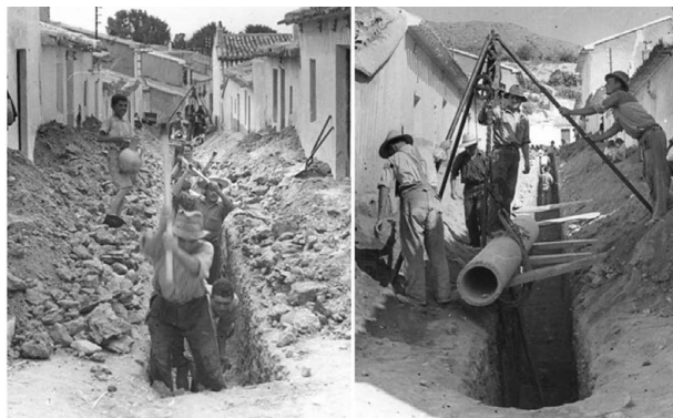
Figura 9. Izq.: excavación de zanja para tubería de alimentación. Dcha.: instalación de tubería de alimentación. Año 1951 (Fuente: MCT).
