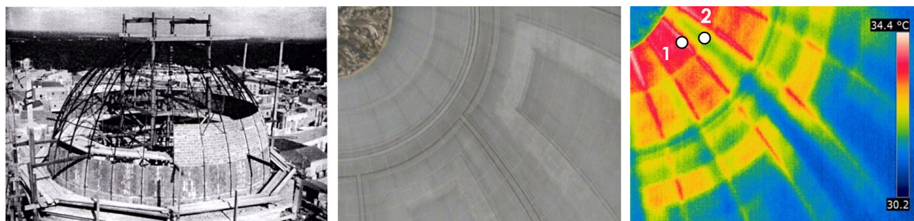
Figura 8. Imágenes de la Iglesia de Santa María de Elche. Imagen izquierda. Estructura metálica base para soportar la cúpula de ladrillo. Imagen central. Vista interior de la cúpula. Imagen derecha. Termografía de la cúpula con identificación de temperaturas destacadas T^a_1 (34,0 °C) y T^a_2 (32,0 °C). (Fuente imagen izquierda: García Navarro et al. (13), p. 82. Fuente imagen central y derecha: propia).
