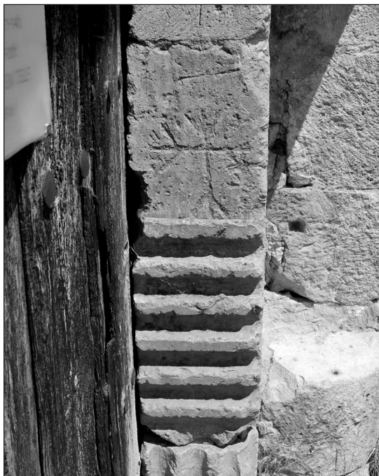
Figura 28. Jamba derecha. Elemento nº 15.
