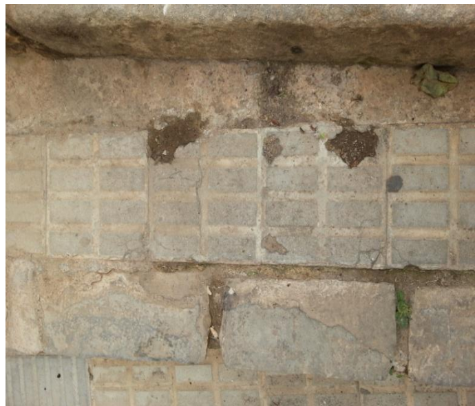
Figura 52: Estado actual de los escalones C/San Roque. Fuente: Autora.
