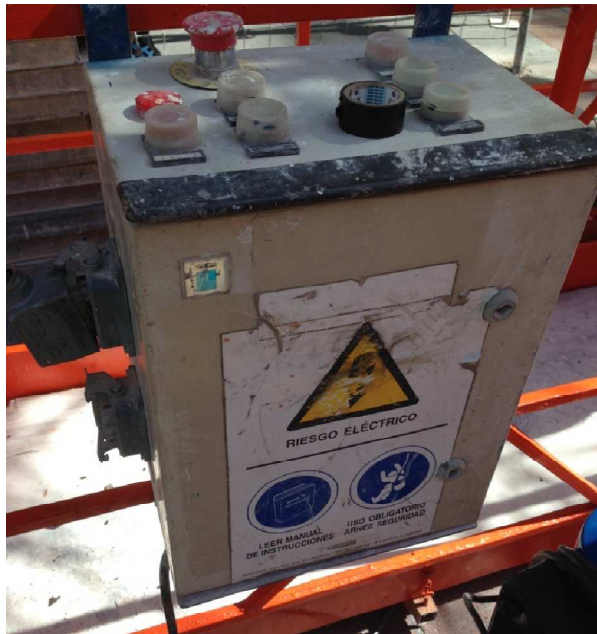
Figura 12. Cuadro eléctrico de mando de conexiones. Fuente: Elaboración propia.
