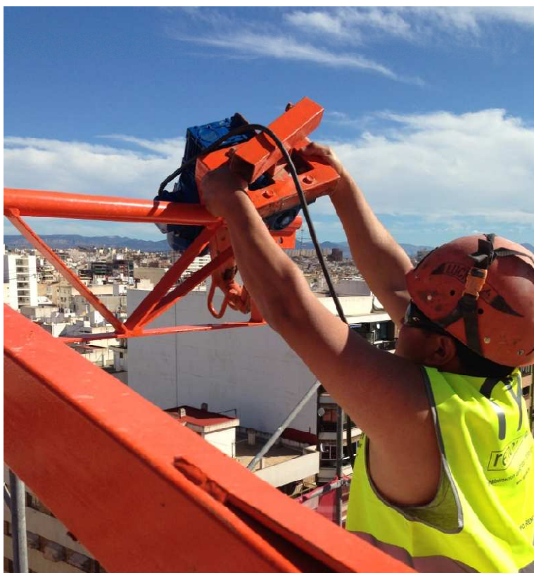
Figura 20.c. Colocación de los carros en el tramo de raíl. Fuente: Elaboración propia.
