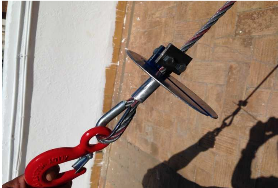
Figura 27. Cable de seguridad con tope final de carrera. Fuente: Elaboración propia.
