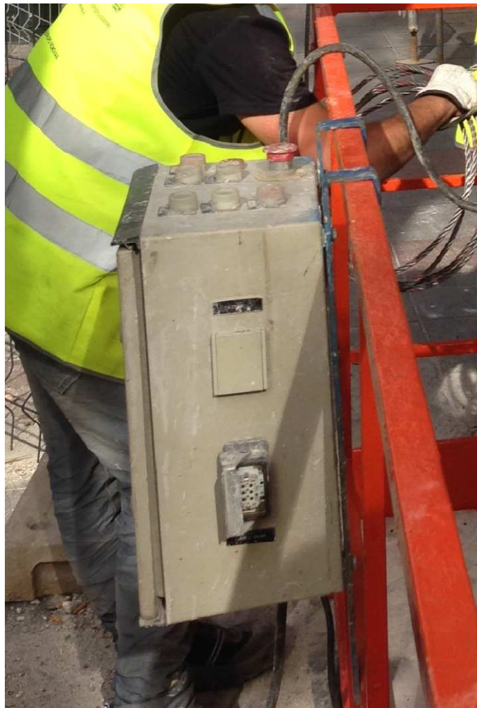
Figura 29. Conexiones de los aparejos de elevación y final de carrera y de los carros. Fuente: Elaboración propia.
