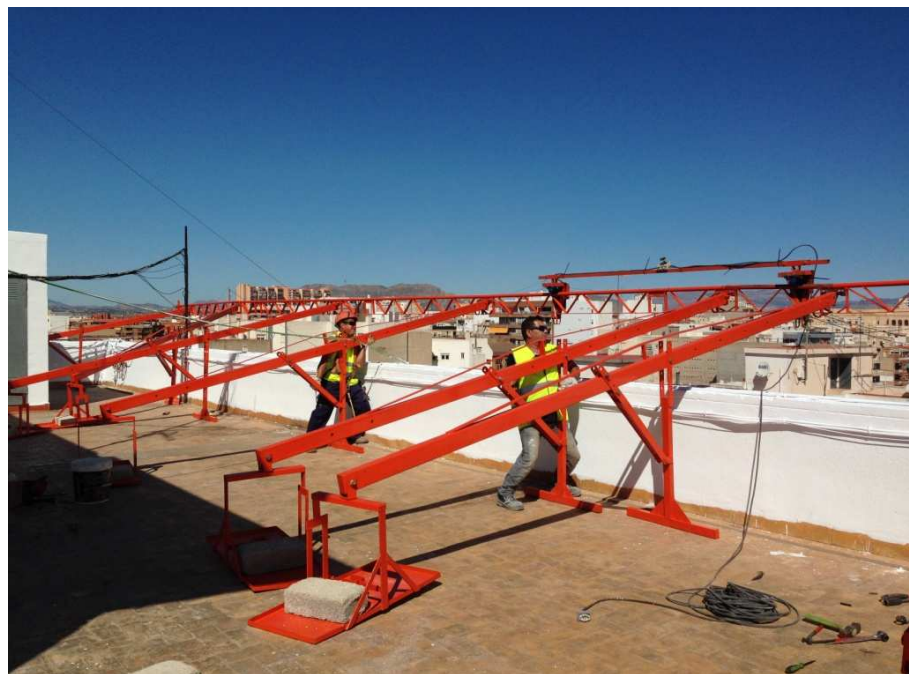
Figura 24. Desplazamiento de la estructura. Fuente: Elaboración propia.
