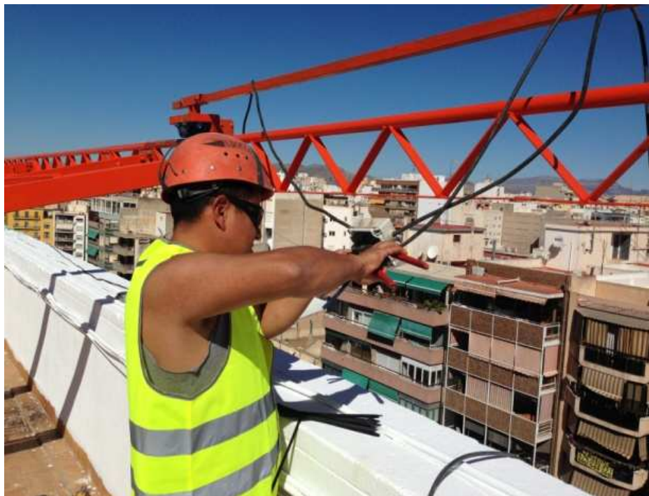
Figura 22.a. Conexión eléctrica de los carros. Fuente: Elaboración propia.
