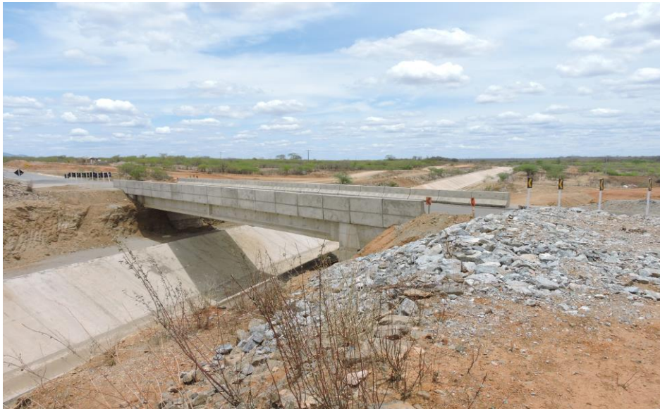
Figura 28 - Área desmatada em função da construção do canal da transposição, município de Sertânia
