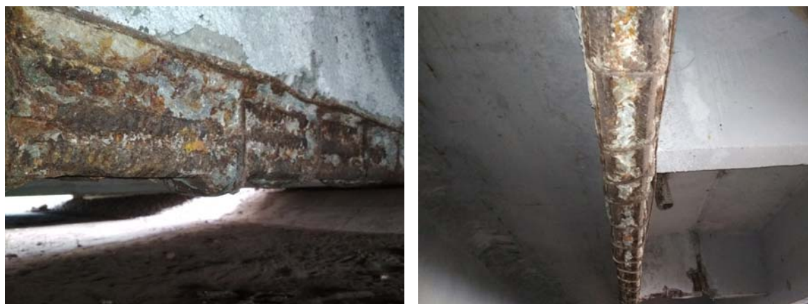
Рисунок 1 – Разрушение балки пролётного строения, после удаления слабого бетона
