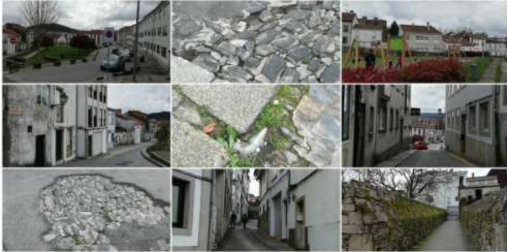
2: ENTRADA A SAR DESDE BELVÍS E A RÚA PATIO DE MADRES; RÚAS DOS PEXIGOS E DESPERFECTOS NAS CALZADAS.
