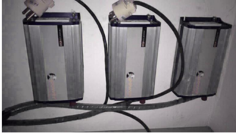
FIGURA 67. PRUEBA DEL SISTEMA FOTOVOLTAICO CON TRES INVERSORES
