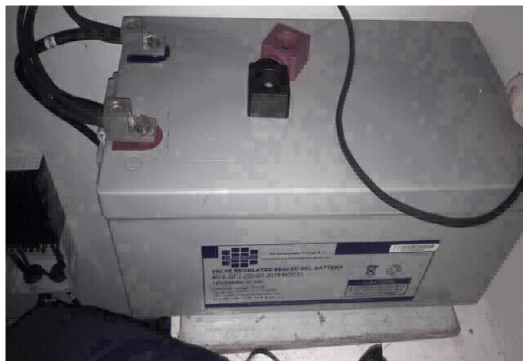
FIGURA 64. BATERÍA DEL SISTEMA FOTOVOLTAICO
