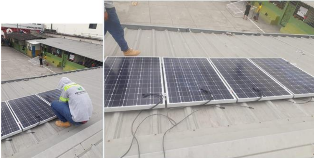
FIGURA 61. PANELES SOLARES INSTALADOS EN EL SISTEMA FOTOVOLTAICO
