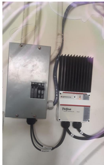
FIGURA 63. MANTENEDOR DE CARGA (REGLADOR) DEL SISTEMA FOTOVOLTAICO
