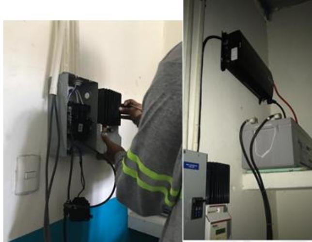
FIGURA 62. CONEXIONES DEL SISTEMA FOTOVOLTAICO
