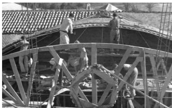
fig. 6.33.a|b. Diferentes fases de ejecución de las obras de los establos y cochiqueras.
