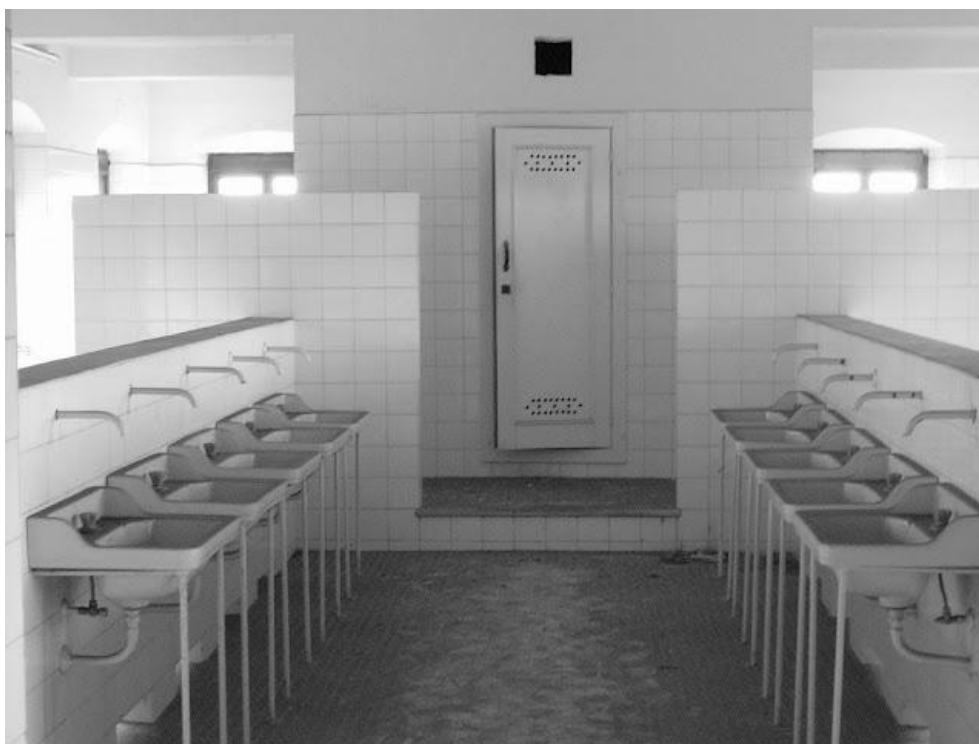
fig. 6.15. Los amplios aseos comunitarios que se distribuían de manera regular en zonas centrales de los pasillos.
