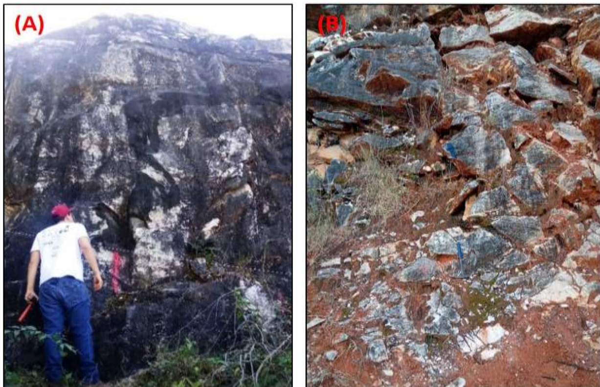
Figura 13. Classes de maciço rochoso: (A) maciço classe I (RMR > 81); e (B) maciço classe IV/V (RMR > 40). Notar em (A) a ausência de fraturas e em (B) um maciço todo fraturado e “afrouxado”, com presença de solo de preenchimento nas fraturas. Fonte: Autor.
