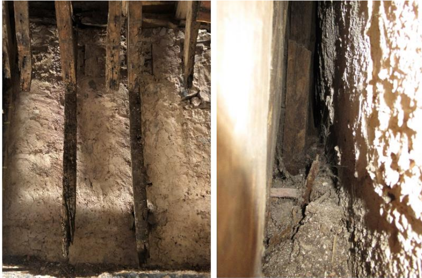
Figura 25 - Parede Sul com evidência de a) Lixo e detritos acumulados entre o revestimento b) Degradação dos montantes
