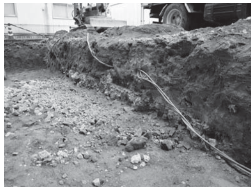
19-6 コンクリート床2 撤去状況とコンクリート床断面 （南より）
