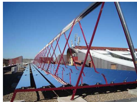
Figura 2: Colectores solares Fresnel.
