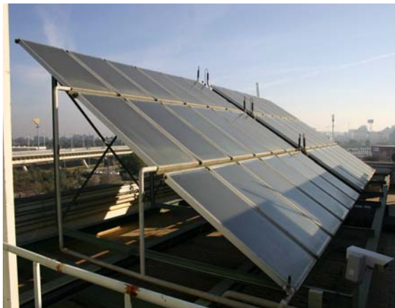
Figura 1: Planta Solar situada en el Instituto de Automática de Andalucía
