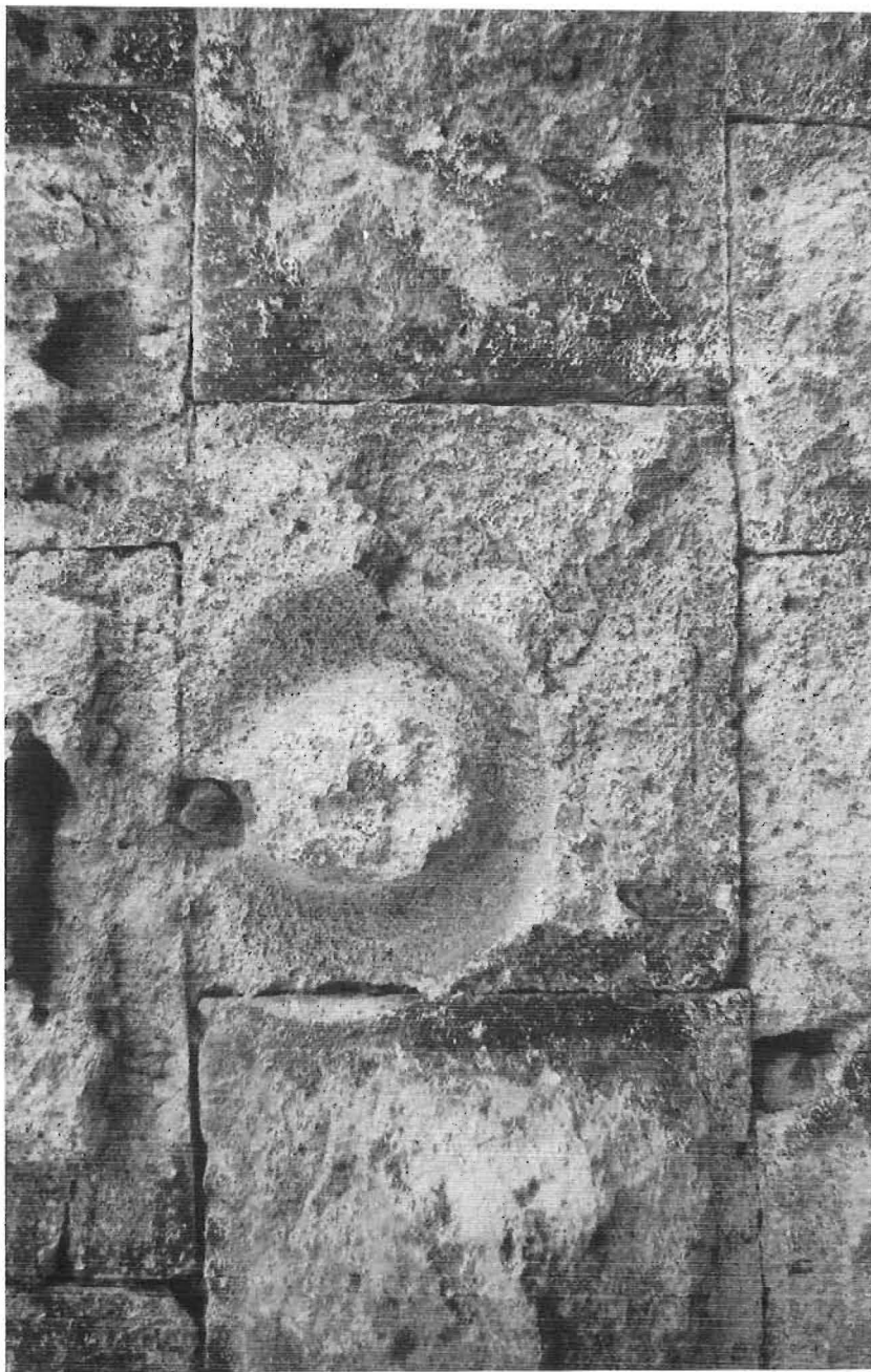
8. Tarquinia, torre in via degli Archi, particolare della muratura con segno di consumo dovuto all'anello per cavalcature
