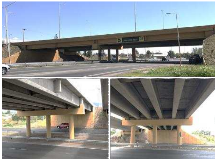
Figura 1: Imagen del puente existente sobre el paso a distinto nivel de RP10 sobre RN40.
