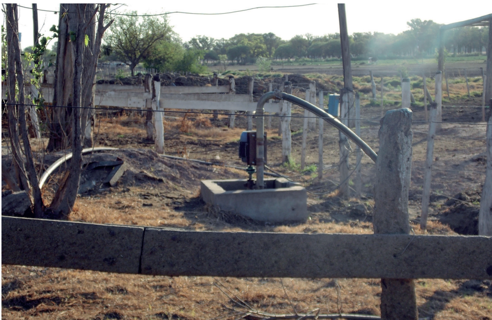
Foto 19: Construcción bien hecha con la boca del pozo elevada y protegida por un reborde de concreto.
