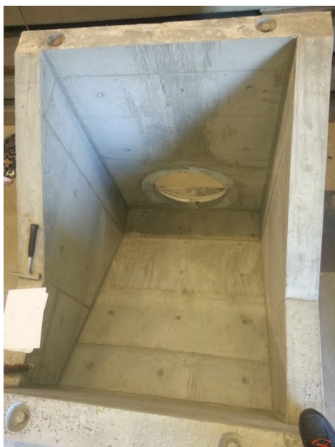
Bilde 16 til venstre. Her ser vi det på murkronen av frontveggen og bakveggen er montert de 4 innstøpte løfteankrene (Foto: Morten Austdal).
