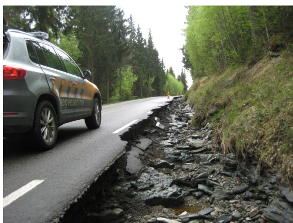
Bilde 2 Viser bilde skader på fv. 255 Skåbuvegen (foto: Asbjørn Stensrud)
