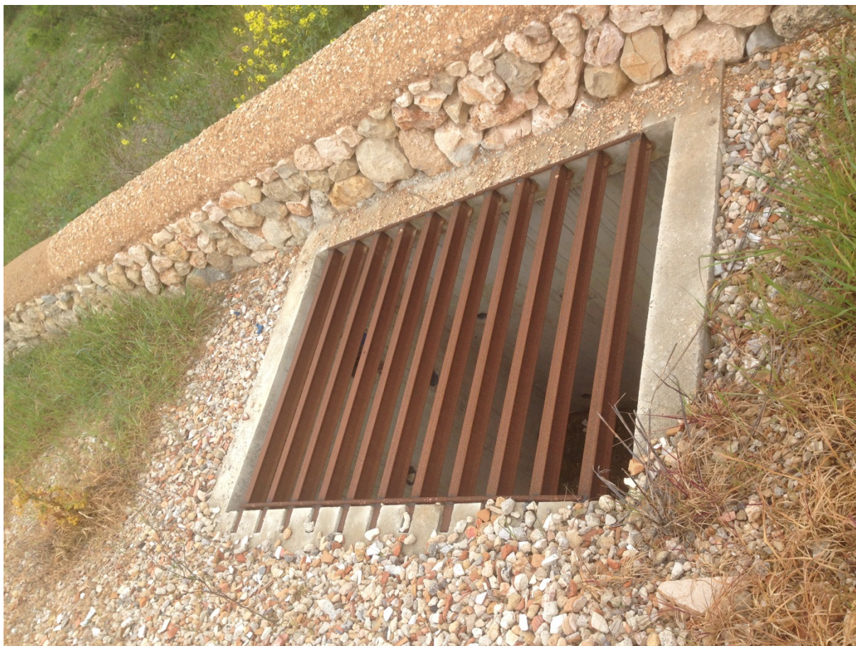
Bilde 18 Inntak for overvann på Mallorca i Spania (Foto: Per Arne Kolseth)
