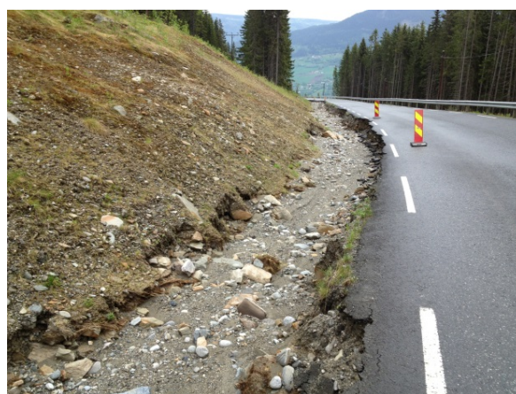
Bilde 3 Viser skader på ny veg etter flommen som følger av tette stikkrenner (foto: Steinar Myrabø)
