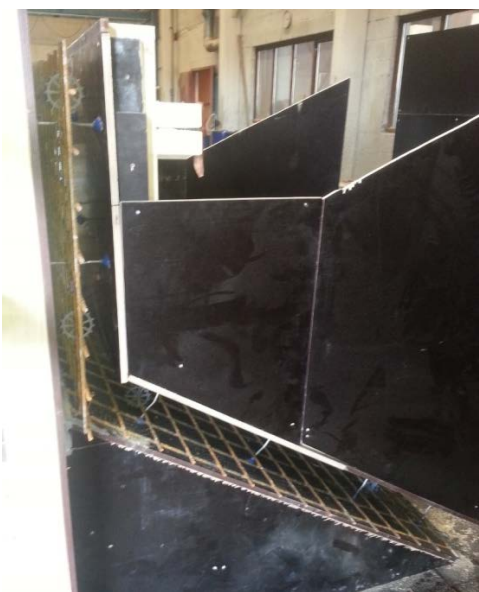
Bilde 11 Armeringen i bunnplaten og bakveggen ligger sentrisk i konstruksjonen. (Foto: Morten Austdal)
