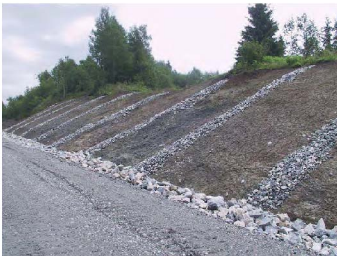
Bilde 5 Viser nedføringsrenner langs jordskjæring (Vegdirektoratet 2010a)
