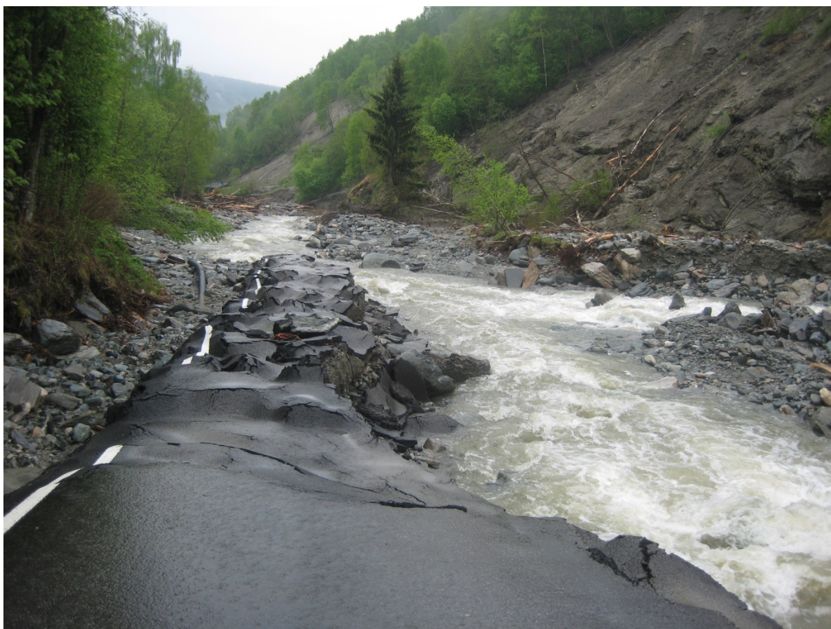
Bilde 1 Viser hvilke skader vann på avvei kan gjøre! (Foto: Asbjørn Stensrud)
