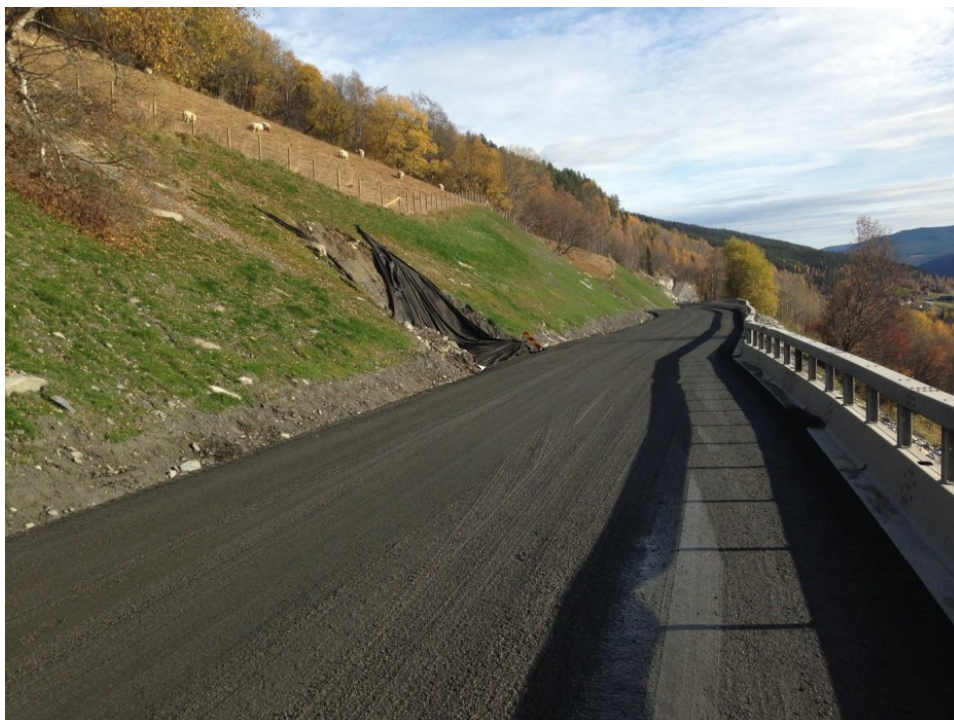
Bilde 6 Viser ekstra masseuttak i skjæring fremfor stikkrenneinntaket (Foto: Per Arne Kolseth).
