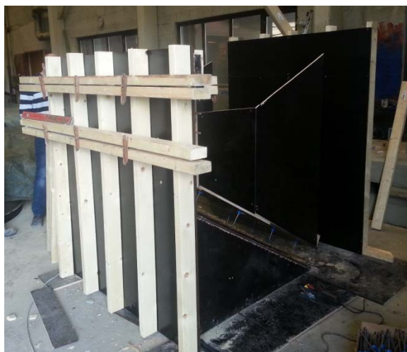
Bilde 10 Inntaksløsningen sett fra siden – bakre kant. Ser forskalingstagen som holder de indre kassene i sammen. (Foto: Morten Austdal)
