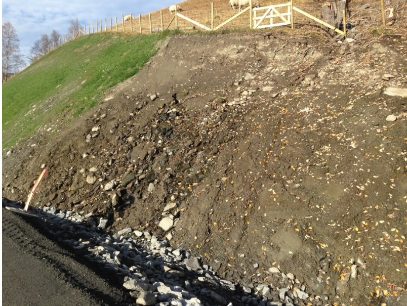
Bilde 4 Overflateerosjon i nybygd skjæring. (Foto: Rune Dahl)
