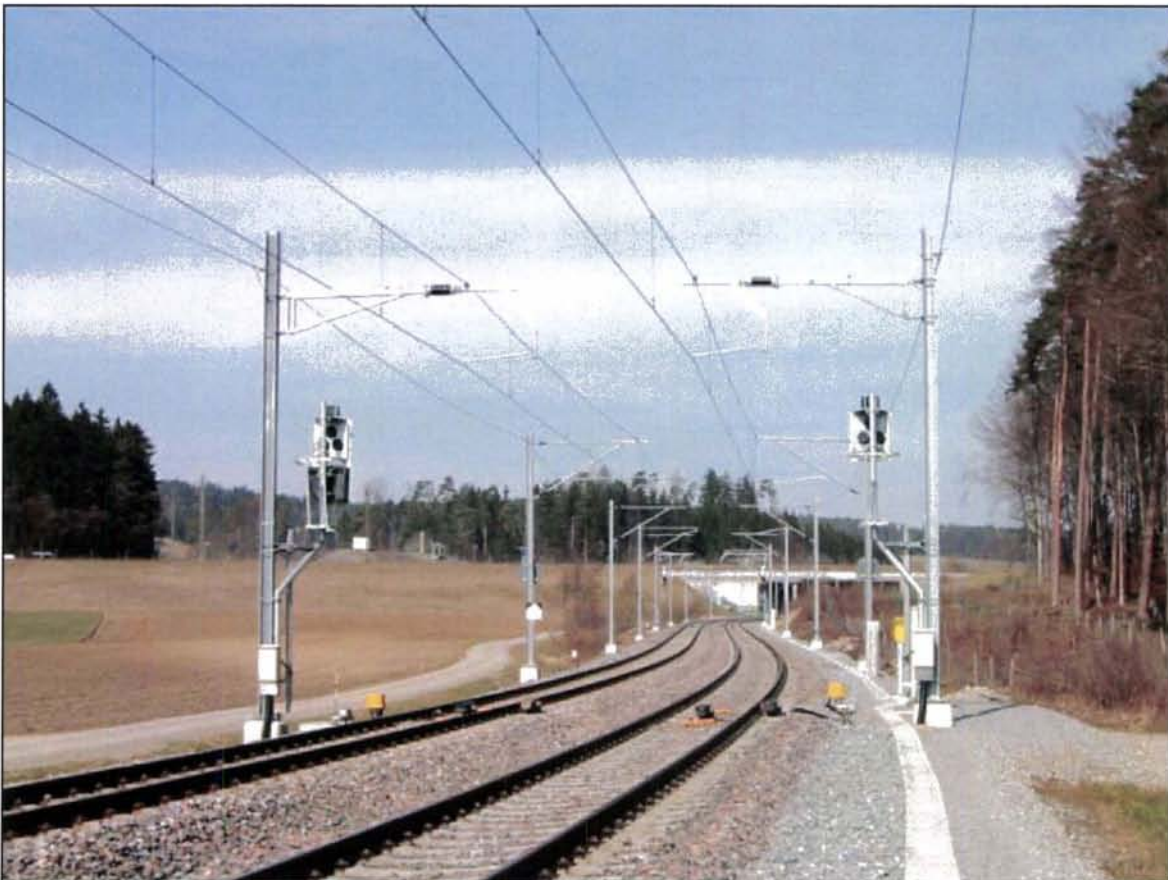
Kjøreledningsanlegget av SBB-strekningen Hettlingen - Henggart (Winterthur - Schaffhausen) med dobbeltspor
