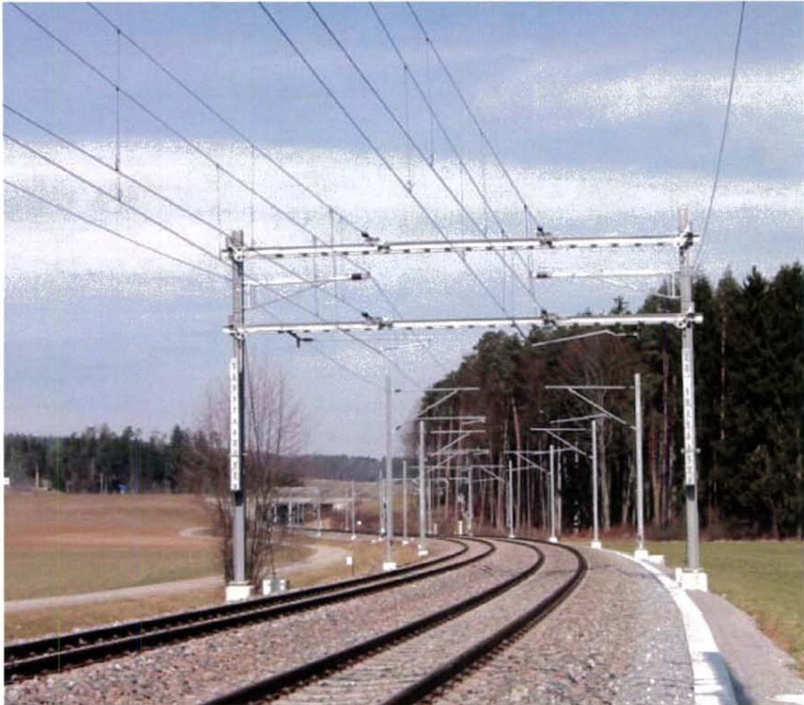
Kjøreledningsanlegget av SBB-strekningen Hettlingen - Henggart (Winterthur - Schaffhausen) med dobbeltspor; avspenning
