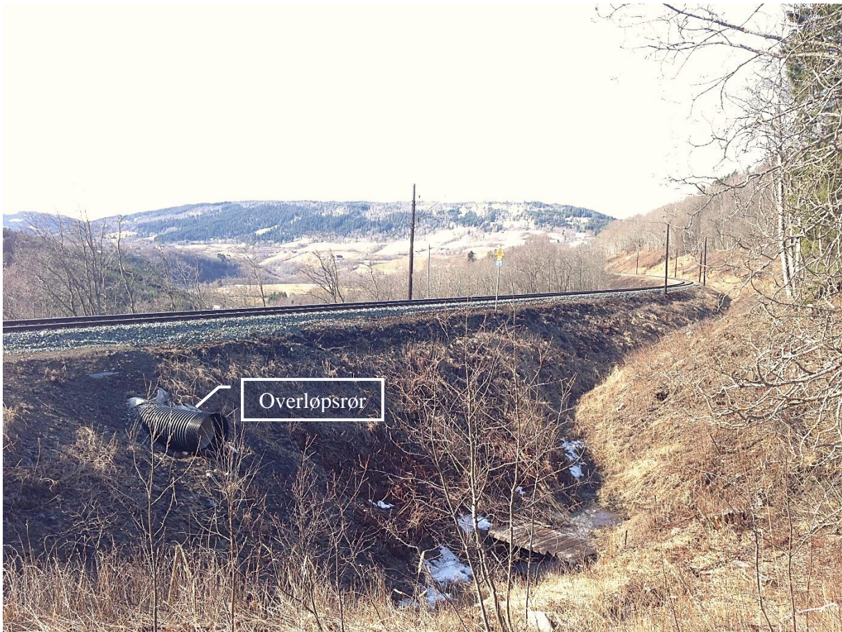
Figur 6.2 Bildet er tatt fra bunnen av skråningen og viser overløpsrøret som er lagt inn med formål om å begrense konsekvensene av et eventuelt skred i overliggende terreng. Foto: Hilde D. Jordet, 11.04.16
