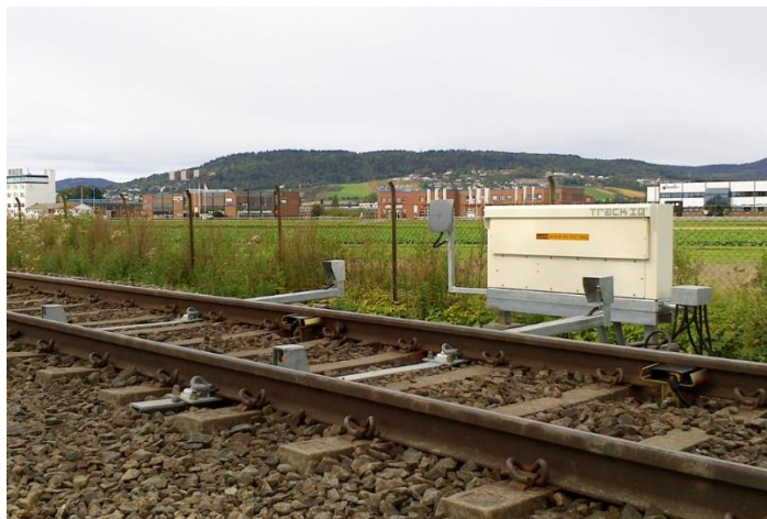
Figur 4.16 – RailBAM-enhet i bruk på Huseby mellom Drammen og Lier. Foto: TRACKIQ
