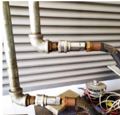
Figura 49. Conexión de las mangueras del banco hidráulico al cilindro doble efecto.
