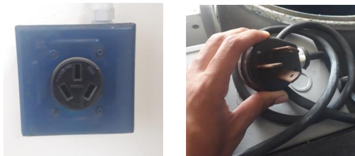
Figura 50. Conexión eléctrica 220v de la caja de control
