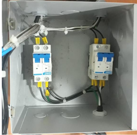
Figura 53. Breakers para encendido de la caja de control.
