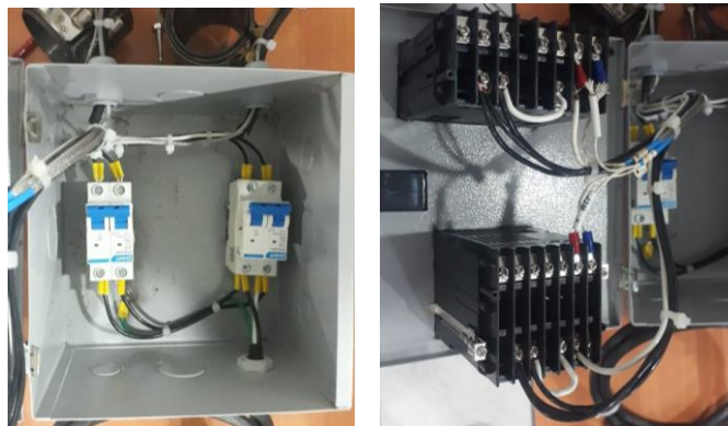
Figura 40. Interior de la caja de control
